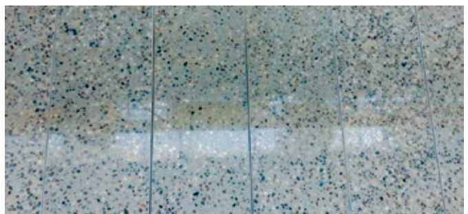
Predgotovljeni betonski brušeni elementi u bazenskom kompleksu Svetice u Zagrebu
